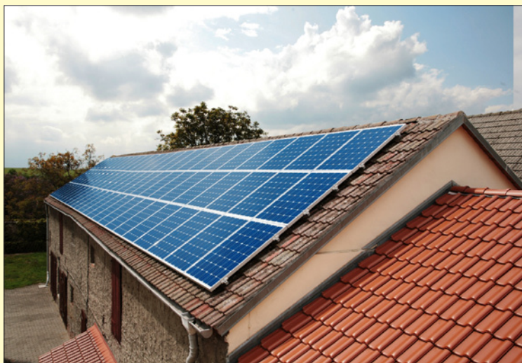
Obr. 3. Střeška hospodářského stavení s FV panely
