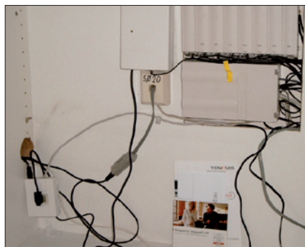
Obr. 3. Úder blesku do stanice mobilního operátora na síle dřevní štěpky; poškození telefonní ústředny [1]
