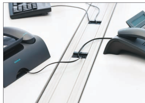
Obr. 6. Vyvedení signálových kabelů ze systému IAS na desku stolu
