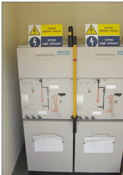
Obr. 2. Zkoušečka napětí 25 kV – pro uvedený rozváděč vn však nevhodná
