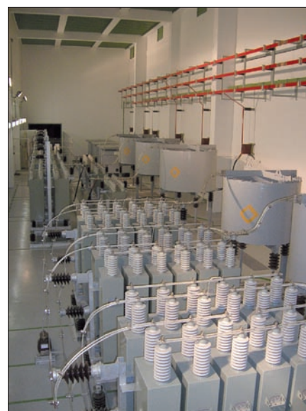
Obr. 4. Filtry 3. a 4. harmonické
