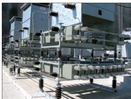
Obr. 2. Kondenzátorové baterie filtru 2. harmonické doplněné rezistory
