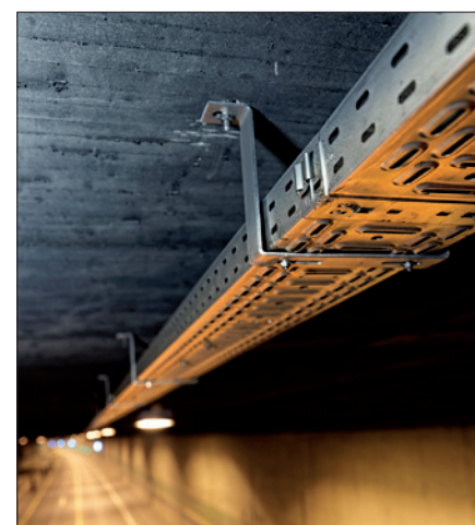
Obr. 8. Kabelový žlab RKS M 620 V4A z korozivzdorné oceli pod stropem automobilového tunelu
