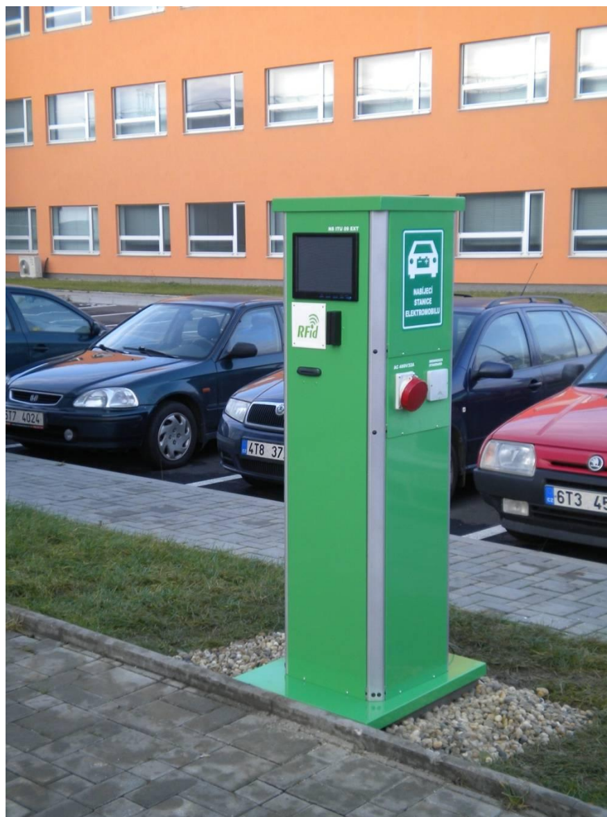
Veřejná nabíjecí stanice VŠB-TUO a její umístění vedle Prototypové laboratoře CPIT v areálu VŠB-TUO v Ostravě Porubě (od 2011).
